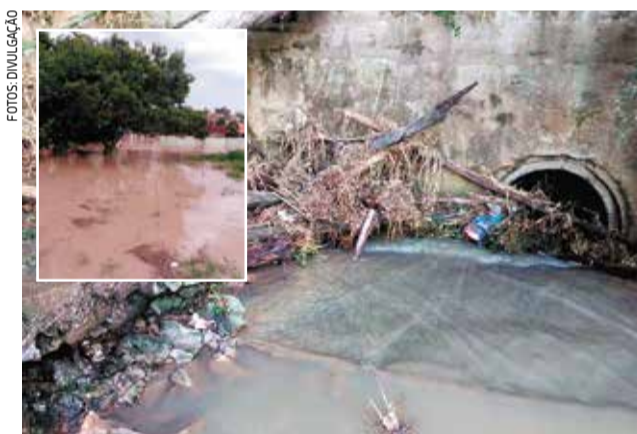
Galhos de árvore e entulho impedem a passagem das águas da chuva em galeria do Jardim São Luiz. (No detalhe), parte do bairro após o temporal do dia 1º de março
