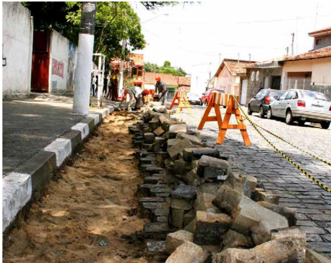
Na rua Alfredo Ramos, os serviços estão sendo executados entre a General Carneiro e a Olímpio Catão
