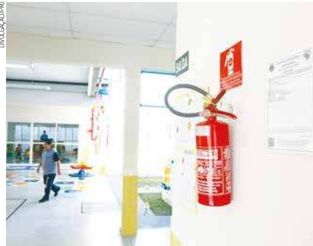
Documento de AVCB afixado ao lado de hidrante em escola
