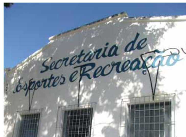
A fachada da Secretaria de Esportes e a lateral da Secretaria de Assistência Social e Cidadania estão pichadas
