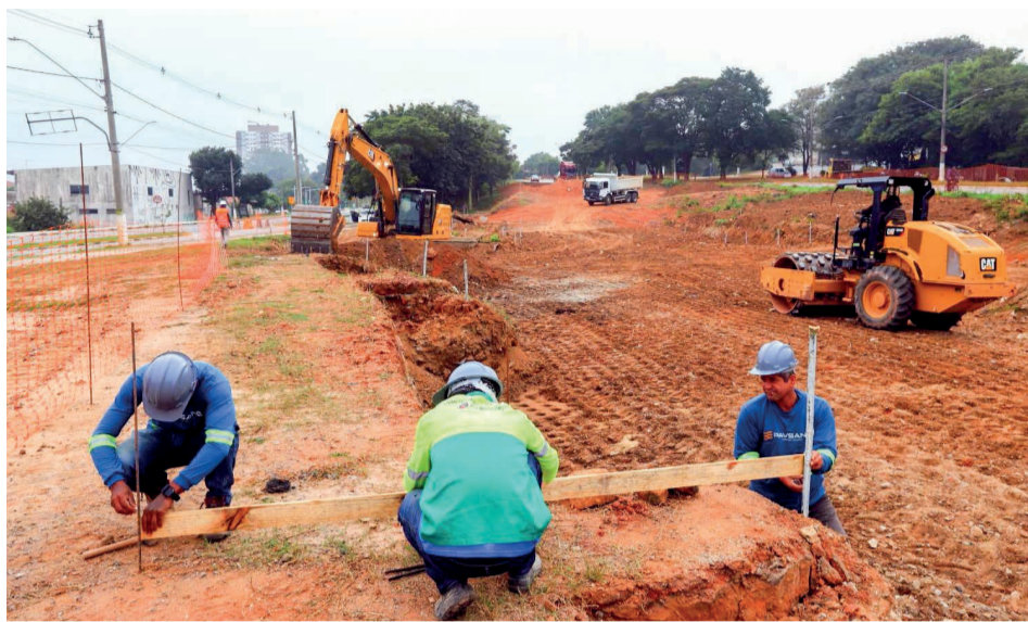
Neste momento, os trabalhos estão concentrados nos serviços de terraplanagem e drenagem
